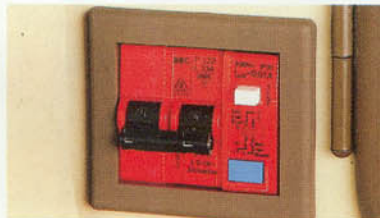
Schutz vor Schaden durch Kurzschlüsse: der Personenschutzautomat.
